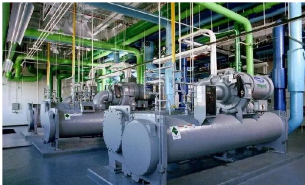
图5 地源热泵机组设备
